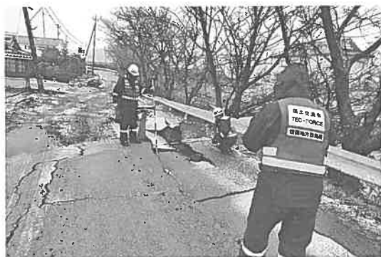
写真2－被災状況調査 (令和6年能登半島地震)
