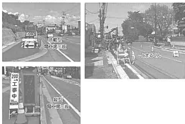
写真－５ 電光掲示板設置及び 車両誤進入時の被害軽減対策
