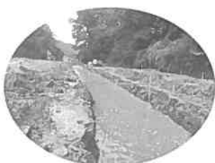
施工箇所浸水状況
