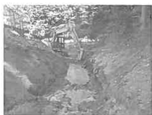
施工時湧水発生状況
