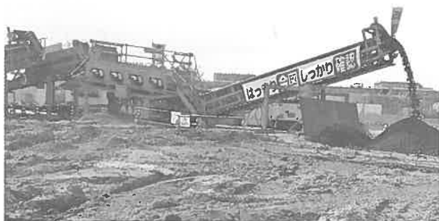
図-3 設備の全景
