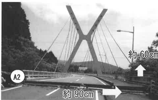
図-3 支承破損による桁の浮上り・横ずれ
