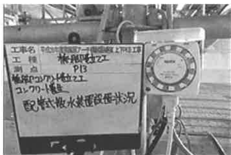
図-11 タイマーで自動散水
