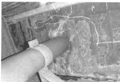
図-1 排水柵部漏水による損傷事例
