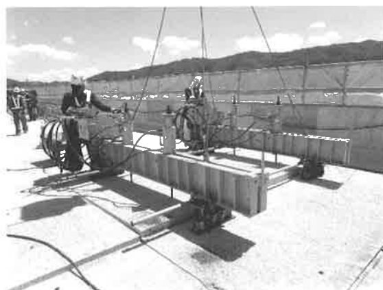
図-3 既設床版剥離
