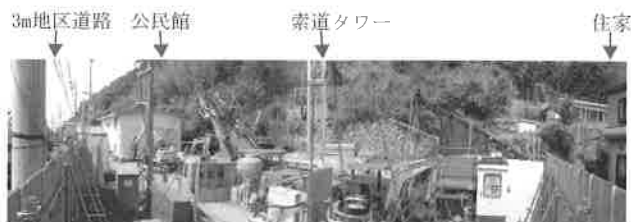
図2 狭いヤードに22台の機器が並んだ
