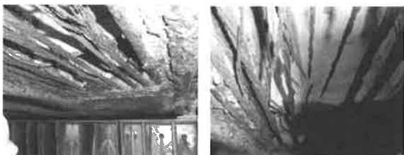
外桁下面の塩害によるひび割れ (PCポステント桁橋)
