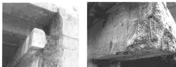
写真-2 塩害や凍害により劣化損傷した事例
