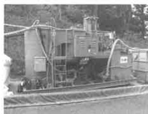
図-7 濁水処理設備
