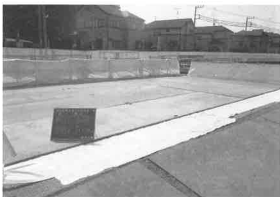
写真－7 作業構台漏油対策
