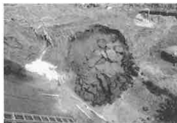
写真-1 堰堤掘削箇所地滑り状況
