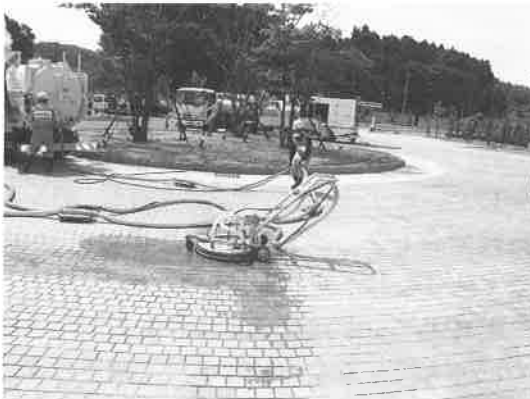
路面洗浄装置
