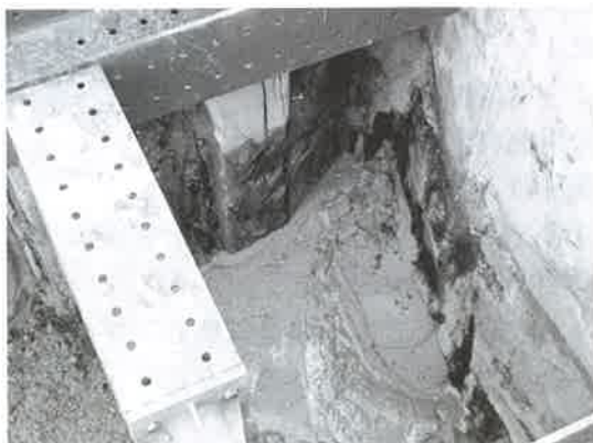
写真-1 出水状況
