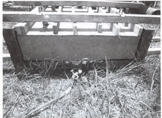
写真-8 壁面A型枠転倒直後 壁面A：型枠転倒直後、コンクリート天端はほぼ垂直に立っていた。
