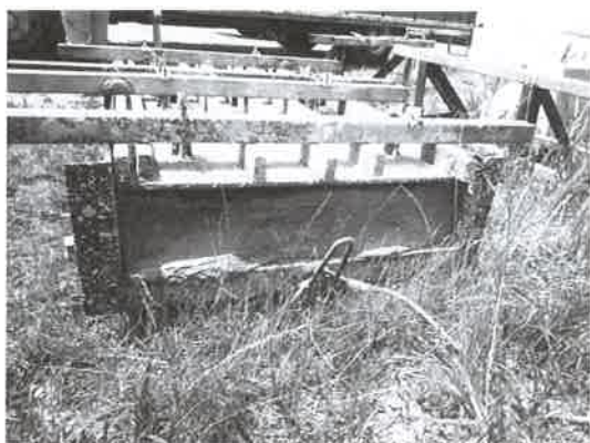
写真-9 壁面B型枠転倒直後
