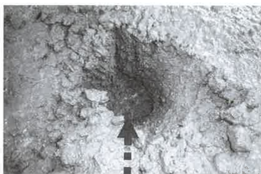
写真-11 壁面Bコンクリート 内部に浮上水分有り
