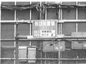
資材の置場明示
