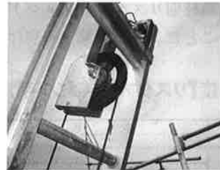
滑車部分が痛んでいるもの
