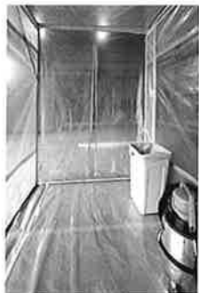
写真-4 「前室」 備品等 設置例
