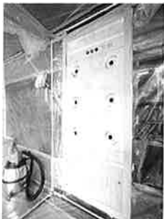
写真-3 「洗浄室」 エアシャワー 設置例
