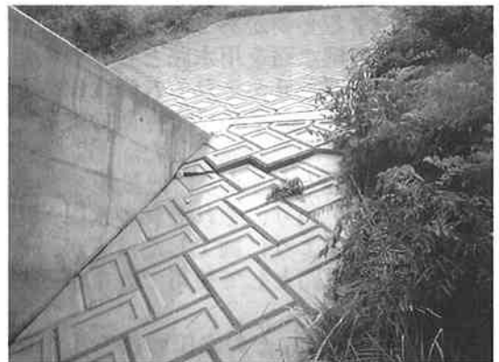
写真-1 張ブロック沈下後
